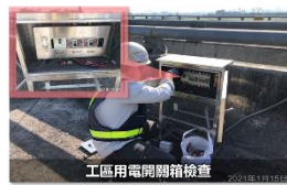
工區用電開關箱檢查
